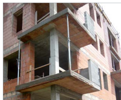
rohový balkón s přidanou výztuží
